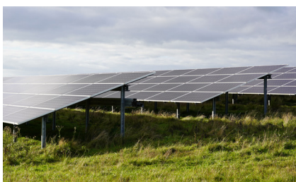
Solcellepaneler på faste stativer.
