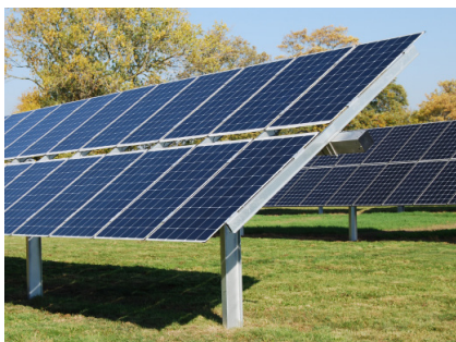
Solcellepaneler på stativer med tracker-mekanisme.
